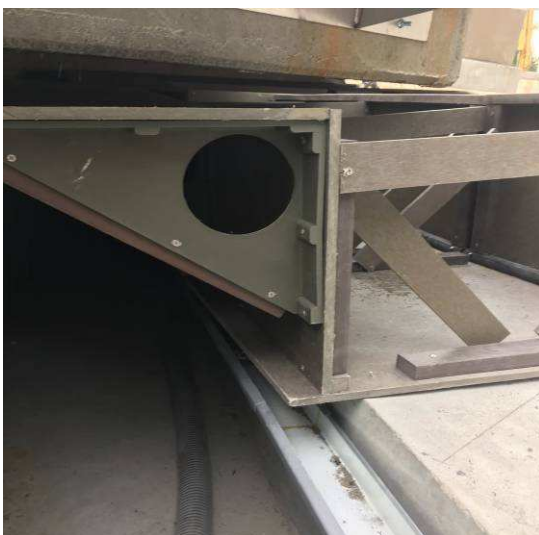
免震フランター設置構造 (受け板は、普段は建物の下に隠れている)
