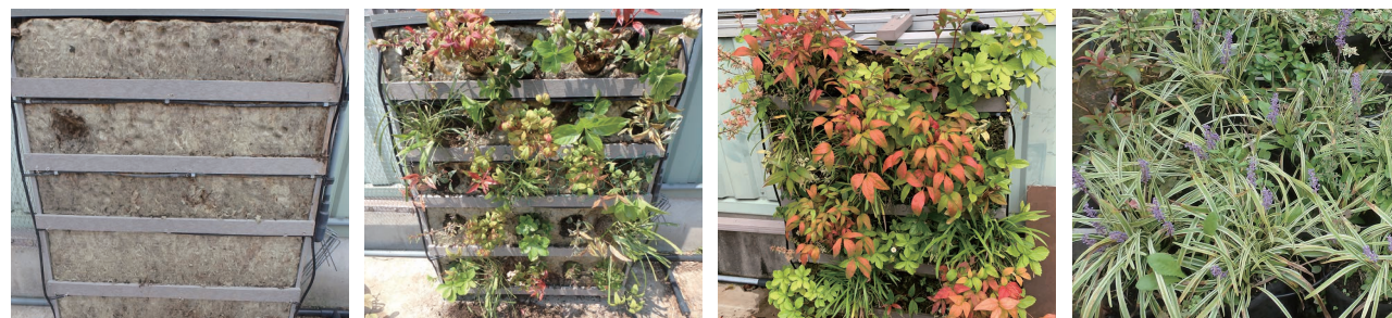
2020.5.1. GRによる壁面緑化 穴をあけプラグ苗挿し 植え込み状況
