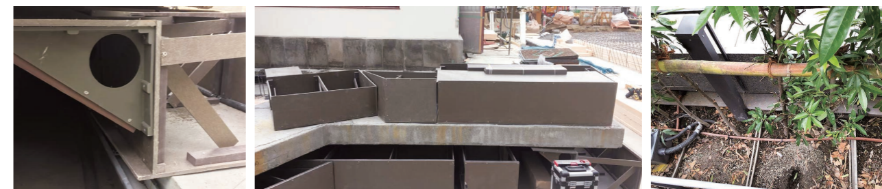
免震プランター受け板は普段は建物の下に隠れている
